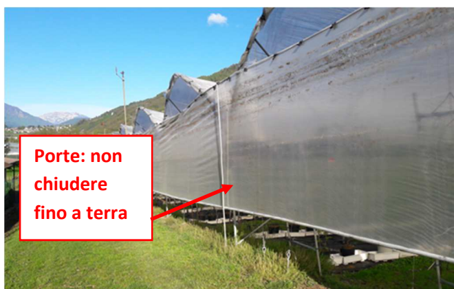
Chiusura porte in nylon dei tunnel
