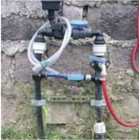
Fig. 4 - Iniettore a tubo di Venturi e temporizzatore per la realizzazione della fertirrigazione in suolo
